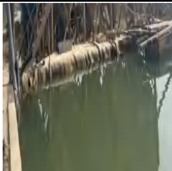
现有工程清水池
